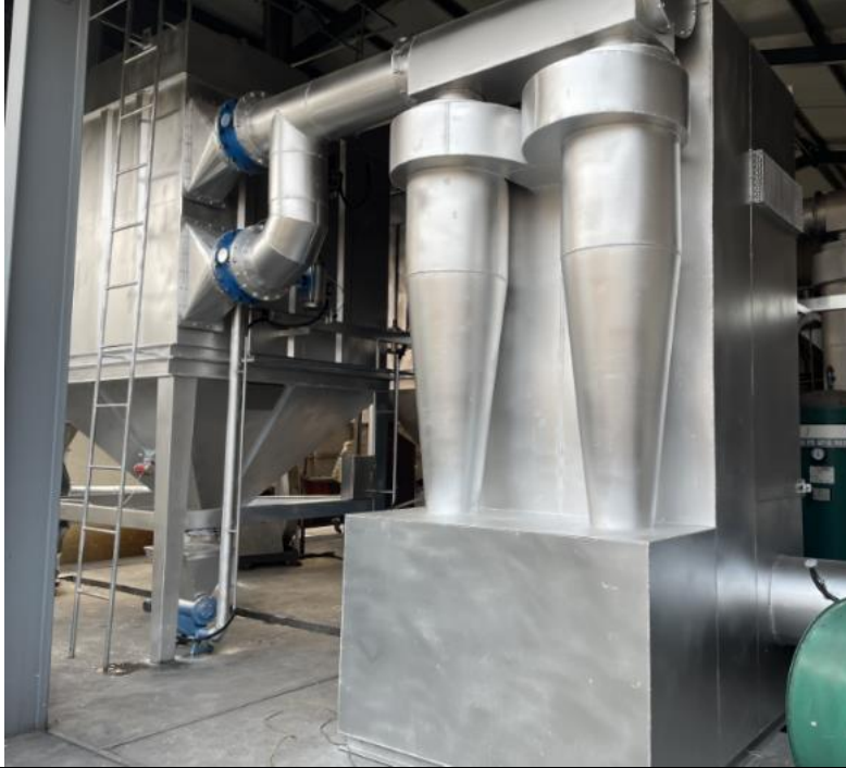
烟气急冷设施、脉冲布袋除尘设施
