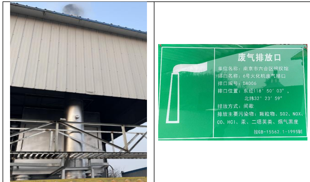
图 3-3 本项目新建排气筒及标识牌
