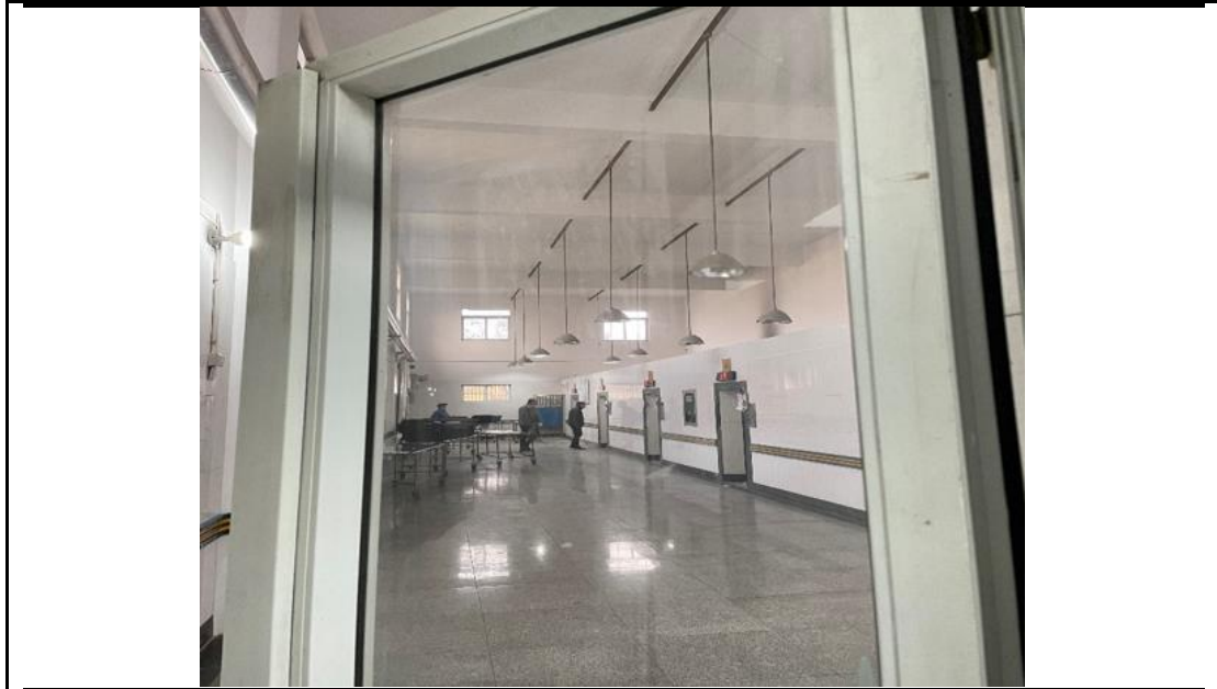
火化组预备间顶面、墙面、地面改造出新及其电路、照明等设施更换
