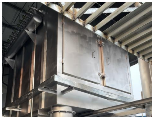
二噁英吸附及重金属脱除设施
