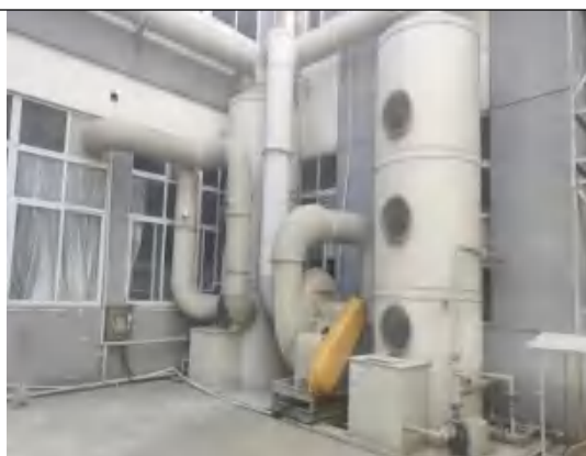
二级水喷淋装置
