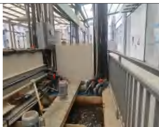
废水分类收集及分类处置
