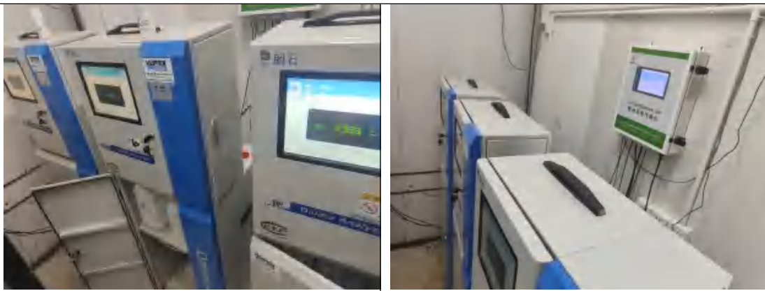
污水在线监测装置
