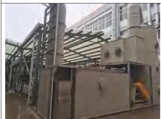
水喷淋+除雾+活性炭纤维吸附装置
