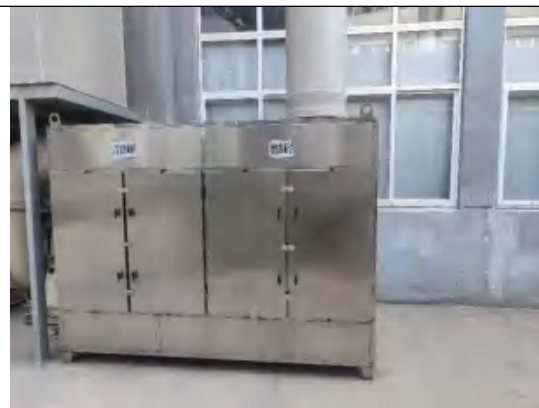
水喷淋+除雾+活性炭吸附装置
