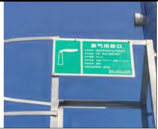
P1 排气筒标识牌
