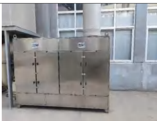
水喷淋+除雾+活性炭吸附装置
