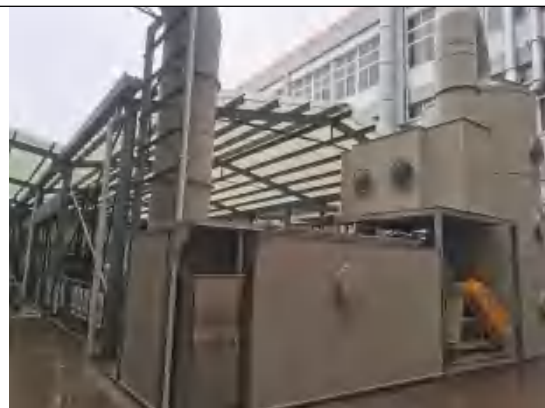
水喷淋+除雾+活性炭纤维吸附装置
