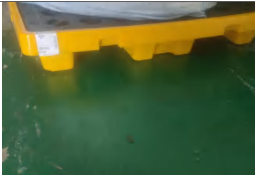
危废间防渗措施
