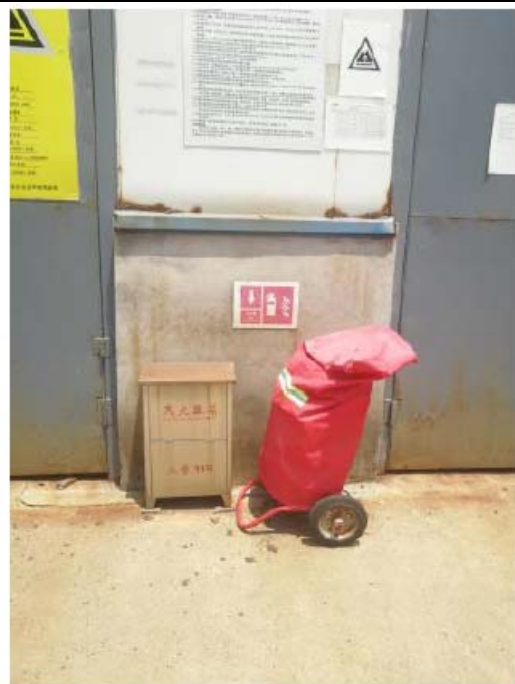
现有危废贮存设施内消防设施
